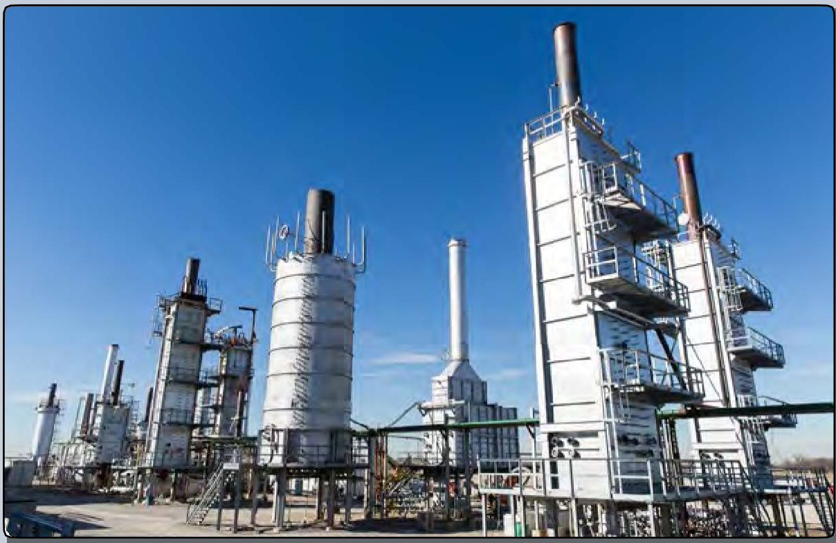
Центр исследования и испытания процессов горения ZEECO
