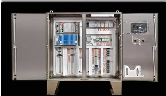
Панель системы управления
