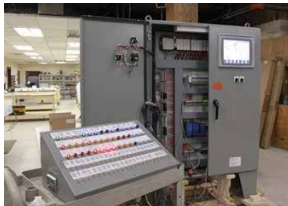
Экран ЧМИ для обзора системы управления горелкой транспортабельного котла
